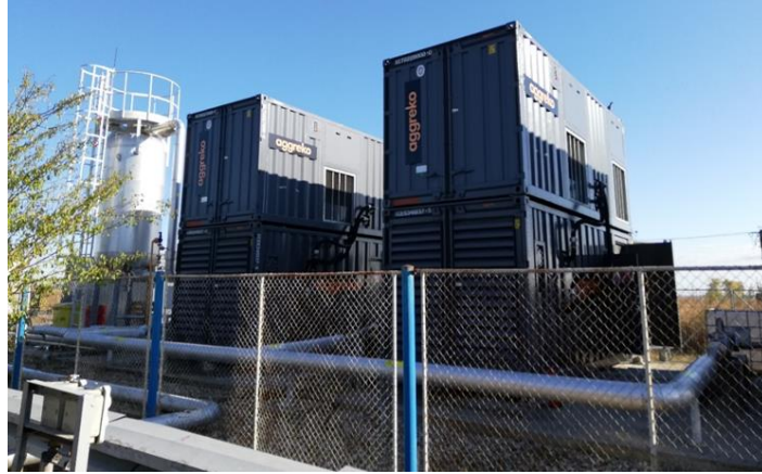
Fig. 2.15. O instalație de generare energie electrică cu motoare termice.
